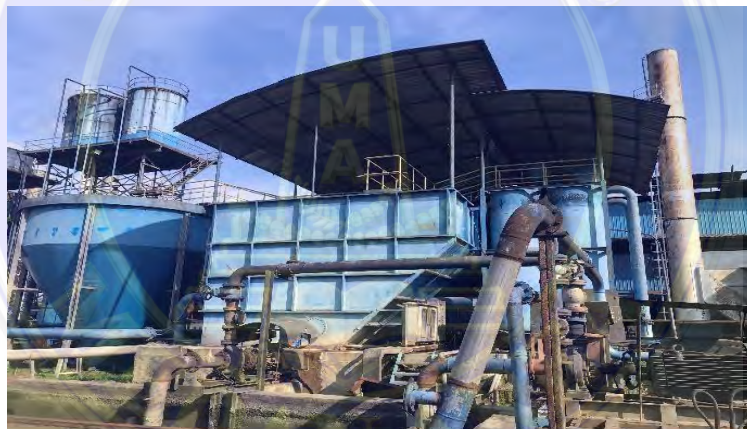
Gambar 3. 33 Stasiun Pengolahan Air (Water Treatment)
