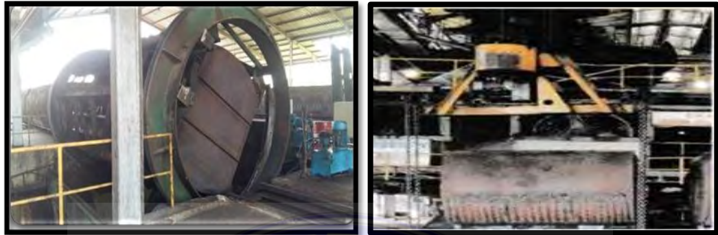
Gambar 3. 10 Hoisting Crane dan Tippler
