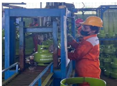
Gambar 3.11 Stasiun Pemasangan Valve
