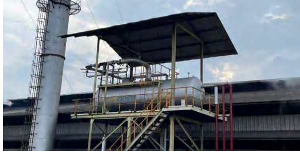
Gambar 3. 59 Thermal Dearator Stasiun Pembangkit Tenaga (Power Plant)
