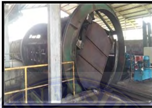
Gambar 3. 12 Hoisting Crane dan Tippler
