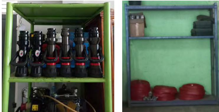
Gambar 4. 8 Rak Fire Nozzle Dan Rak Fire Hose
