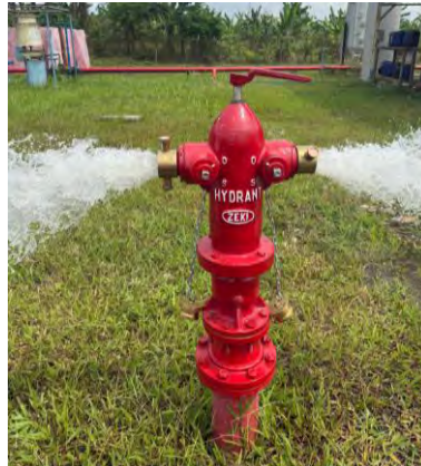
Gambar 4. 9 Hydrant sebagai Sumber Pasokan Air Pemadam
