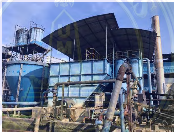
Gambar 3.33. Sasiun Pengolahan Air (Water Treatment)
