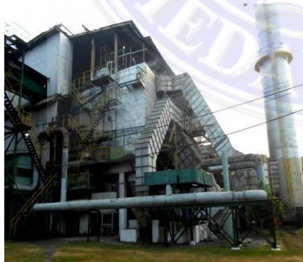
(a) Stasiun Boiler
