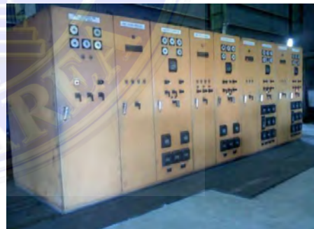
(b) Ruang Kontrol
