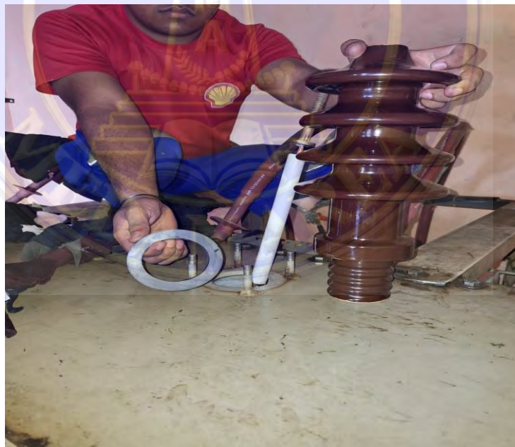
Gambar 4. 2 Pergantian seal dan inspeksi bushing
