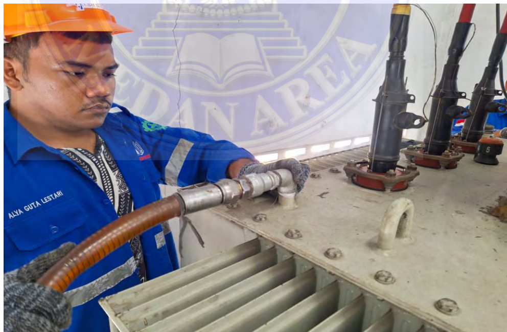
Gambar 4. 1 Pengisian minyak pada trafo
