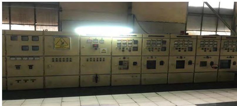
Gambar 3.59. Panel kontrol utama
