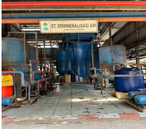
Gambar 3.51 Stasiun Water Treatment
