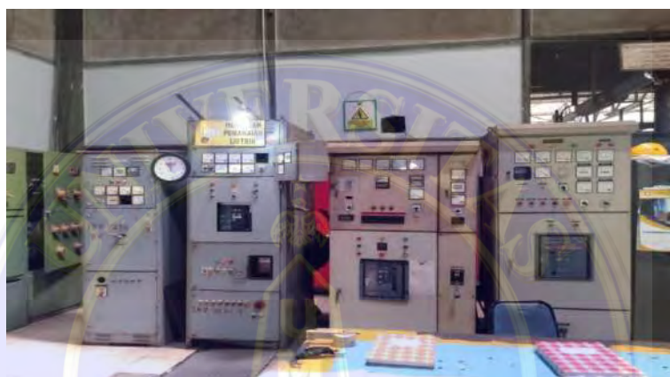
Gambar 3.27 Panel Tenaga Listrik ( PLN )
