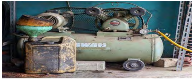
Gambar 2. 16Kompresor Udara ( Air Compressor )
