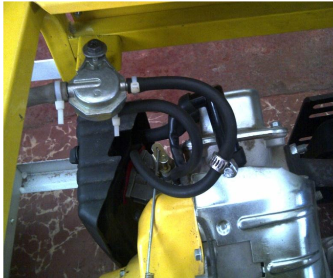
Gambar 2.3 konverter kit pada Genset
