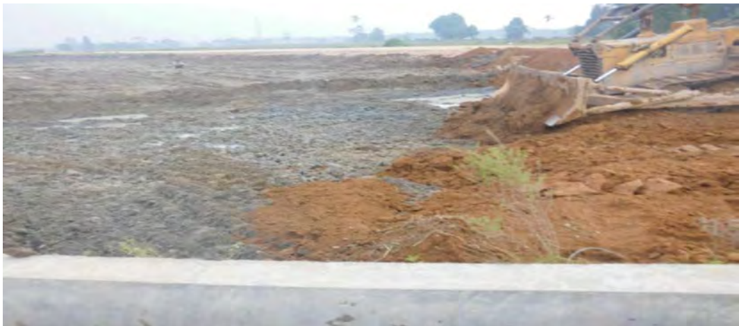
Gambar: Penimbunan permukaan trase jalan tanpa menggunakan geotextile sparator
