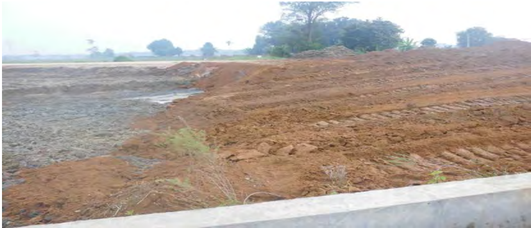
Gambar: Penimbunan permukaan trase jalan tanpa menggunakan geotextile sparator
