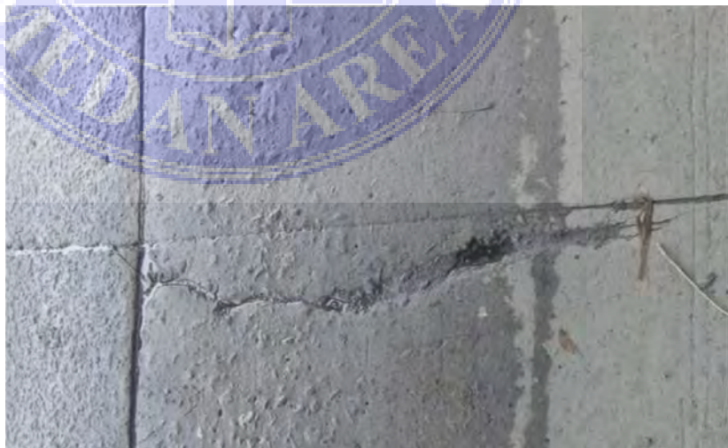
Gambar 3.9. Retak sudut pada ruas kiri jalan Sisingamangaraja
