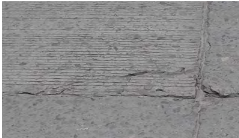
Gambar 3.10. Retak sudut pada ruas kanan jalan Sisingamangaraja
