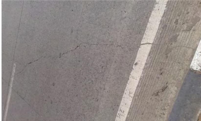
Gambar 3.12. Retak diagonal pada ruas kanan jalan Sisingamangaraja
