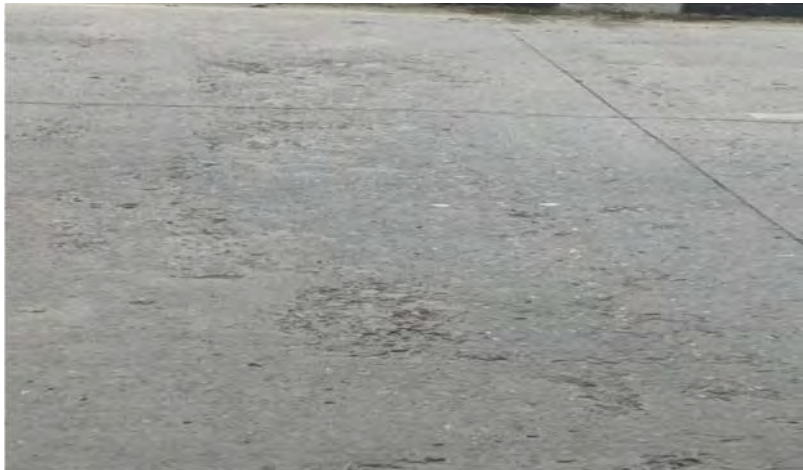
Gambar 3.14. scaling pada ruas kanan jalan Sisingamangaraja
