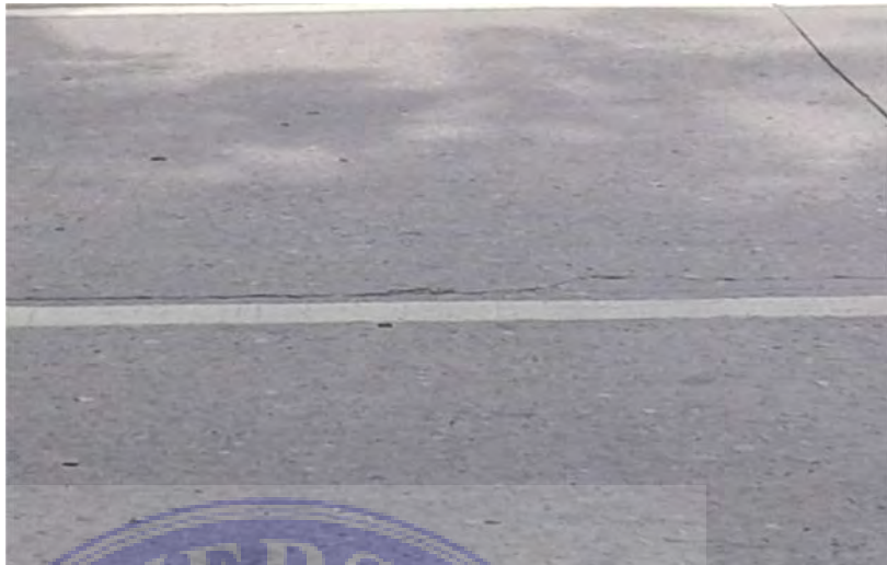
Gambar 3.8. Retak Memanjang pada ruas kanan jalan Sisingamangaraja
