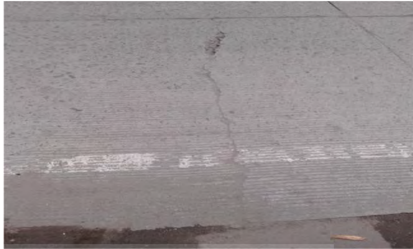
Gambar 3.6. Retak Melintang pada ruas kanan jalan Sisingamangaraja
