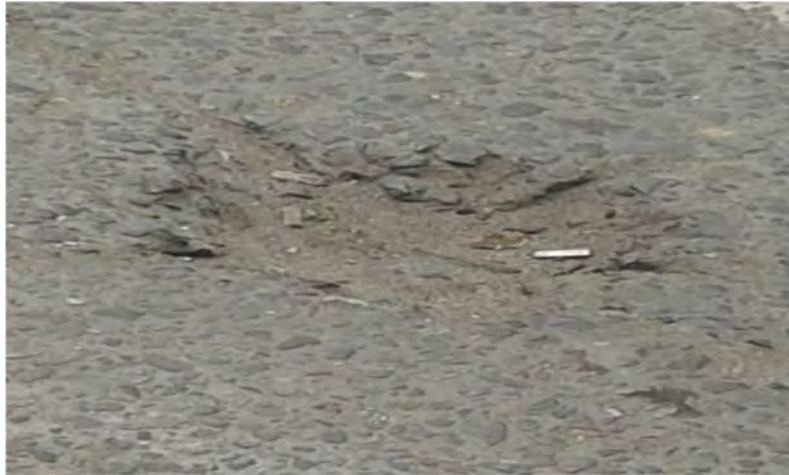
Gambar 3.4. Lubang pada ruas kanan jalan Sisingamangaraja
