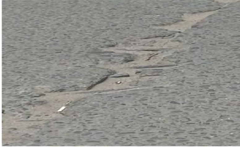
Gambar 3.2. Gompal pada ruas kanan jalan Sisingamangaraja
