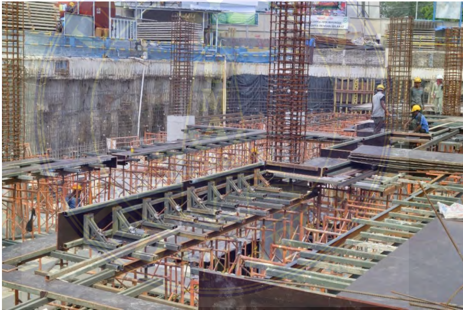
Gambar 2.1 Bekisting pelat lantai dan balok (Sumber: Dokumentasi proyek The Manhattan Mall and Condominium)
